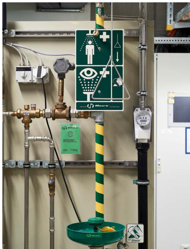
La douche d'urgence dans le local technique du parc des éléphants est équipée du rinçage forcé hygiénique Geberit Rapid, installé dans le cadre d'un essai sur le terrain.
